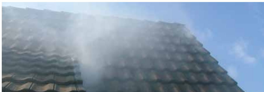
Abb. 1: Messung vor der Sanierung zur Bestandsanalyse. Auf dem Foto ist gut zu erkennen, dass es im oberen Wangenbereich der Schleppgaube eine größere Leckstelle geben muss. Diese kann jetzt bei der Planung und Angebotsabgabe besonders berücksichtigt werden.
