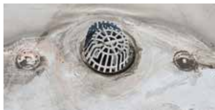
Sanierungsbedürftig: Ein Bestandsgully, vom Alter gebeugt.
