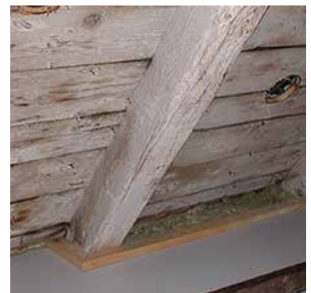
Schimmelpilze mit einer typisch grünlichen Verfärbung vor der Be- und Entlüftungsmaßnahme
