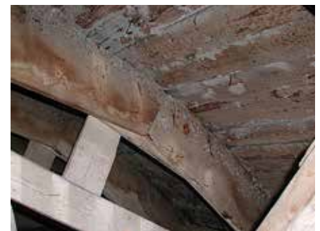
Schimmelpilzbildung auf feuchtem Holzuntergrund
