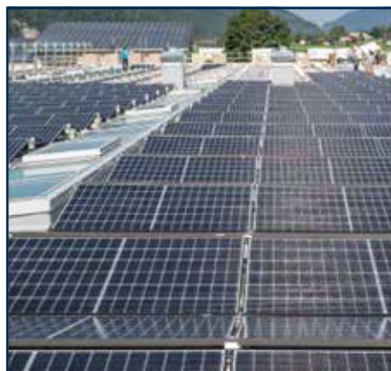
Unter Photo- voltaikanlagen
