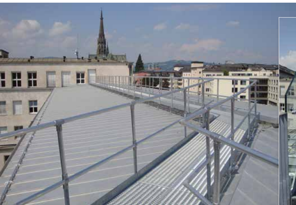
Begehungsanlagen für Instandhaltung
